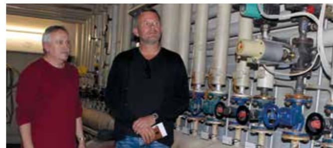
DIETMAR WIESNER (HAUSWART RATHAUS) UND UWE WINEFELD (BEREICHSLEITER WÄRME DER EGG, RE.) BESICHTIGEN DIE FERNWÄRMEVERTEILUNG IM EHEMALIGEN KÖHLEHEIZUNGSKELLER DES RATHAUSES
