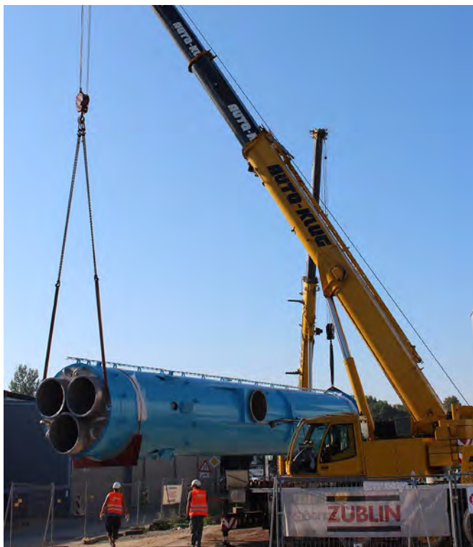
MIT SCHWEREN GERÄTEN WURDEN DIE 30 METER HOHEN SCHORNSTEINE ANGELIEFERT UND IN MASSARBEIT AN IHREM BESTIMMUNGSLORT AUFGESTELLT
