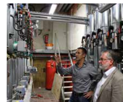
DANIEL TRUMPOLD, TECHNISCHER BETRIEBSLEITER DES THEATERS, UND UWE FUNK VOM VERTRIEB GAS/FERNWÄRME DER EGG ERLÄUTERN DIE FUNKTIONSWEISE DER ANLAGE
