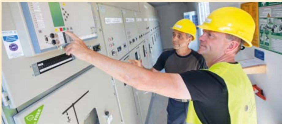
Mitarbeiter der EGG bei der Inbetriebnahme des Schalthauses im IG Cretzschwitz (Foto: Björn Walther)
