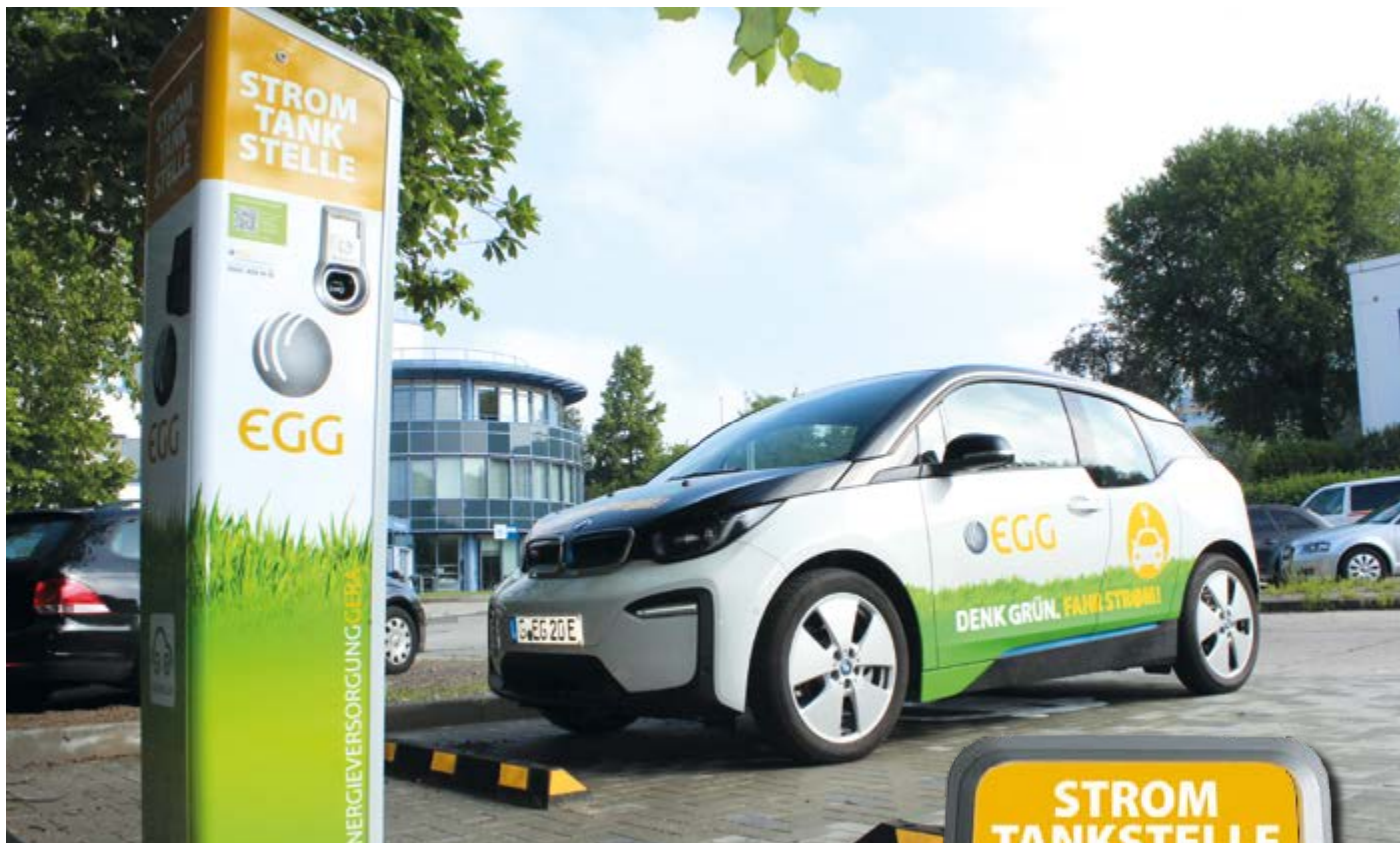
EGG-Stromtankstelle in der Gaswerkstraße in Gera (Parkplatz Nähe IHK Ostthüringen)
